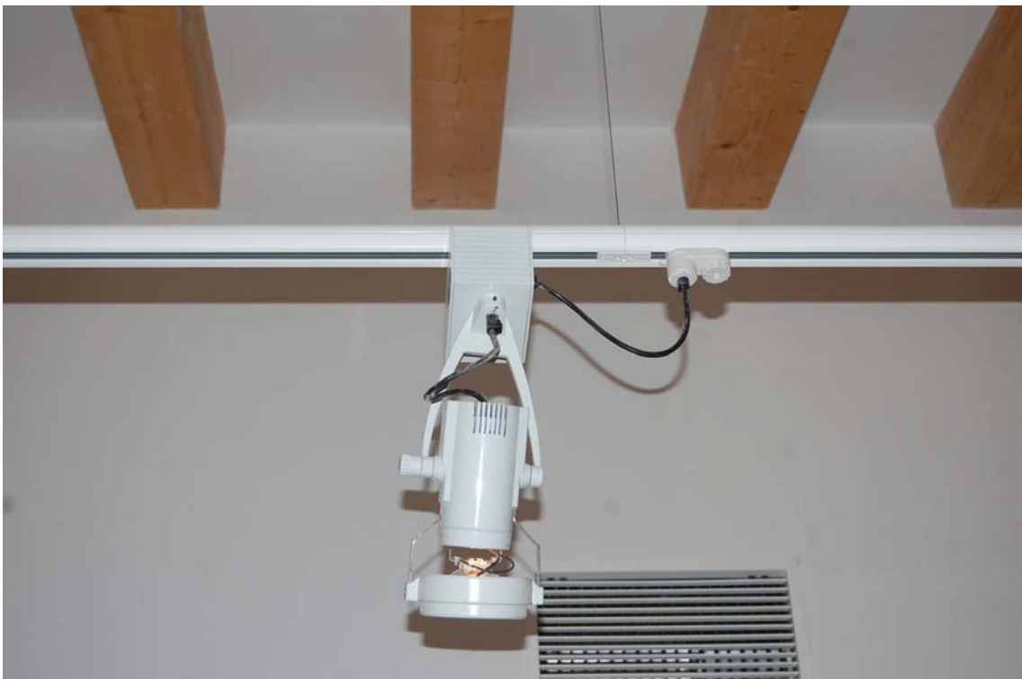
Imagen 28: Detalle de la lámpara y el rail electrificado que se encuentra en la zona expositiva.
